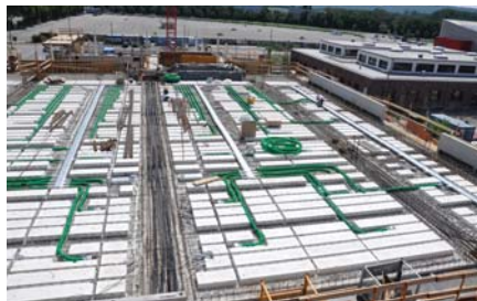
Kreativpark, Karlsruhe: thermisch aktivierte Decke inkl. integrierter Lüftung, Akustik; Projektentwicklung Vollack GmbH, Karlsruhe; Architekt: Vollack GmbH-Karlsruhe.
